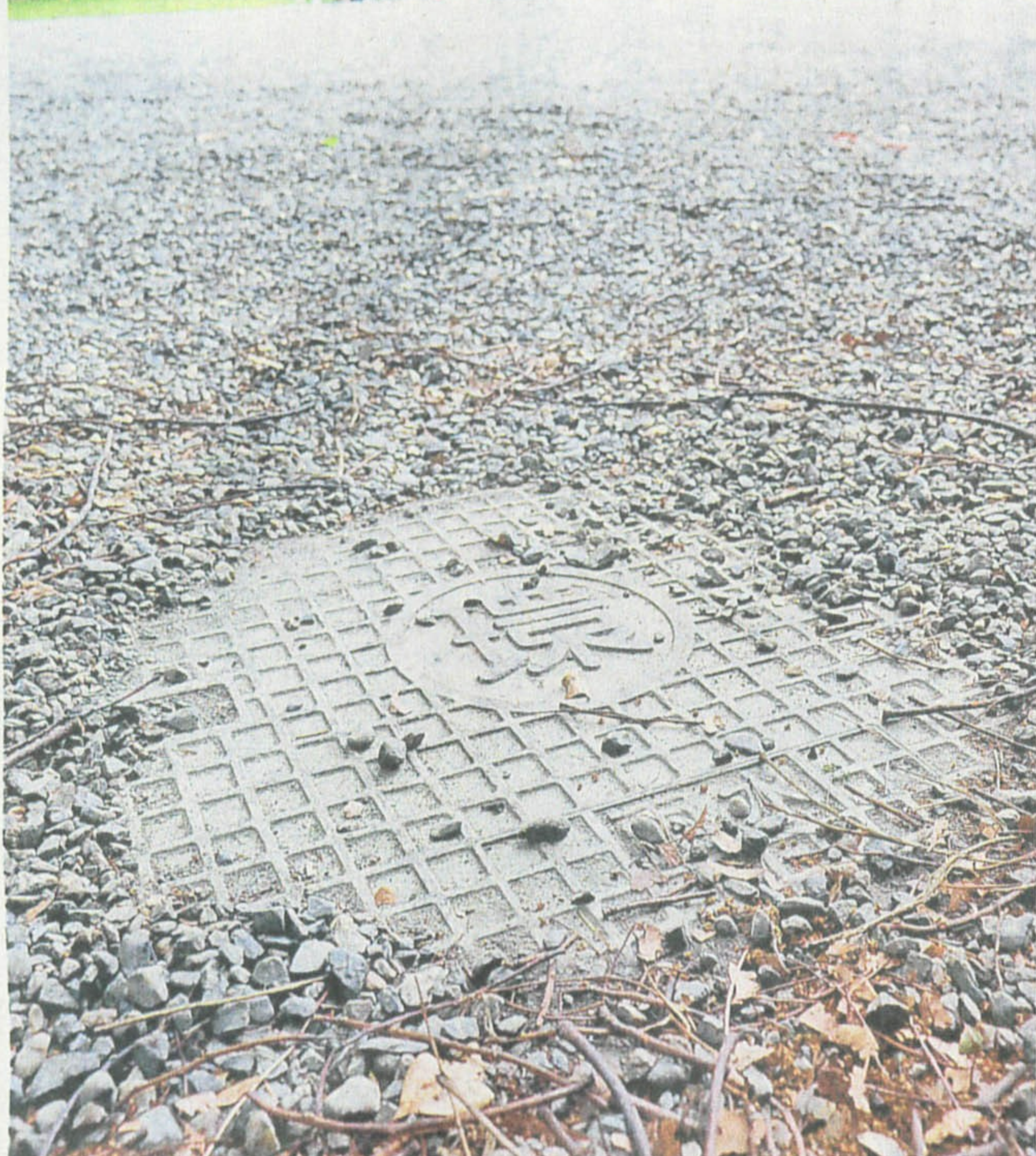
拾翠亭北側にある「環」のマンホール。砂利に埋もれている(京都市上京区・京都御苑)
